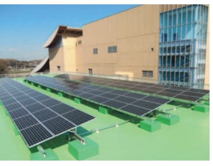
▲東部クリーンセンター太陽光発電システム
