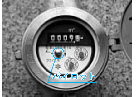
▲水道メーターのパイロット
