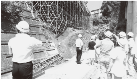
審査に先立ち、山口中学校西側擁壁の崩落現場の現地調査を行いました。
