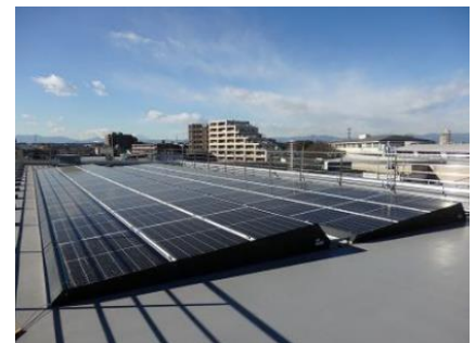
■太陽光パネル（上下水道局庁舎屋上）
