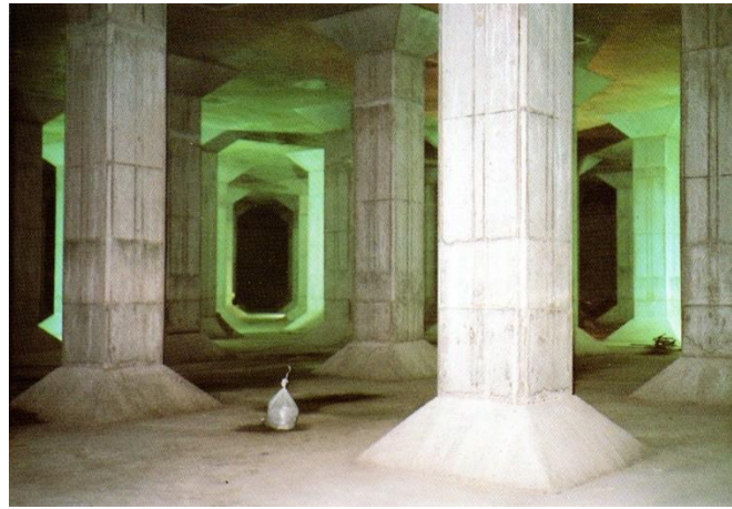
緑町中央公園調整池（地下式）
