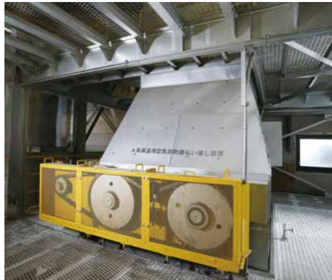
減温用空気加熱器 ガス冷却室を通過した排ガスをさらに冷却する設備です。2,508本の伝熱管に工場内の空気を通すことにより熱交換し排ガス冷却を行います。
