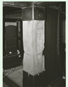
打ちこわしによる柱のきず
